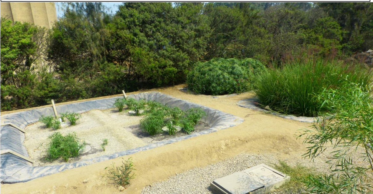
PTAR DE TRATAMIENTO HUMEDALES, UNALM
